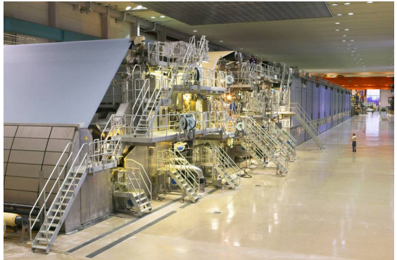
PM12 på Stora Enso Kvarnsveden i Borlänge
